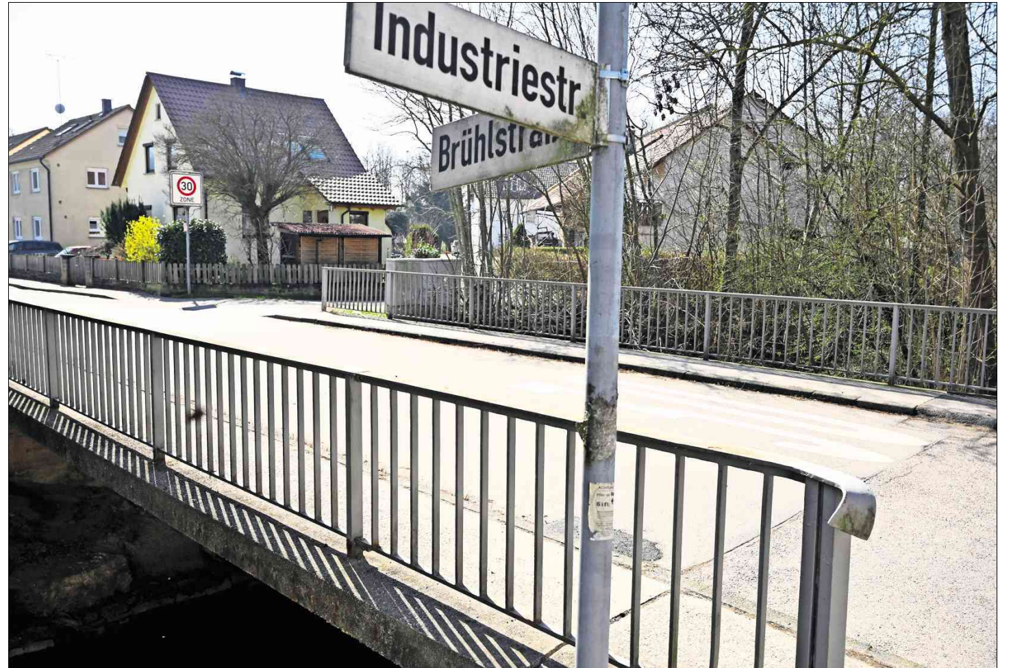
Die Brücke über die Bottwar soll saniert werden und breite Gehwege bekommen.
